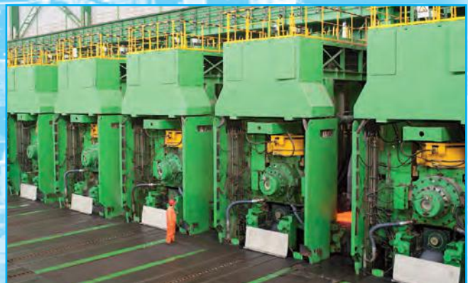
Walzgerüste in einer Warmwalzstraße
