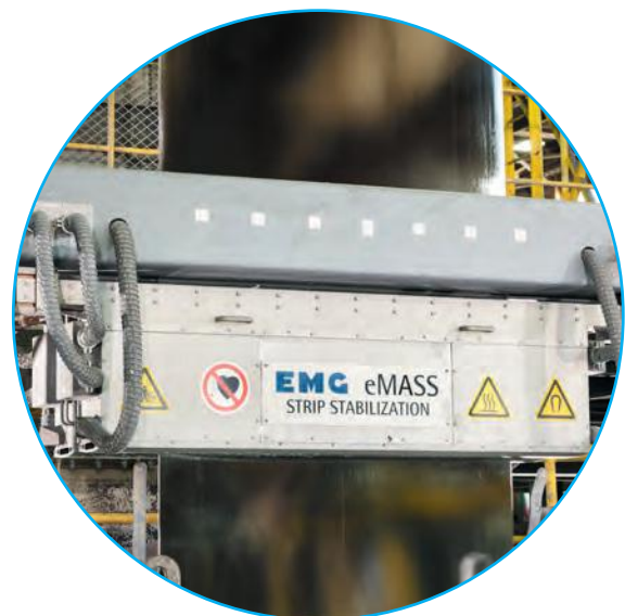
Montage auf der Düse in einer Feuerverzinkungsanlage
