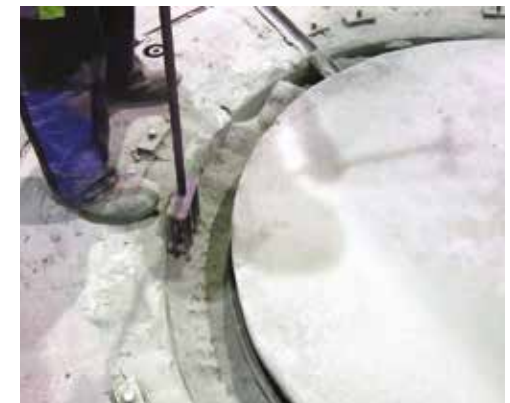
Entlüften während der Zustellung
