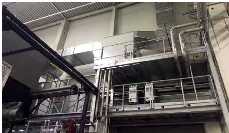
Der Abluftfilter und die Abluftkanäle können auch wie hier bei der zweiten Gießzelle platzsparend neben der Gießmaschine montiert werden / The exhaust air filter and the exhaust air ducts can also be mounted next to the casting machine to save space
